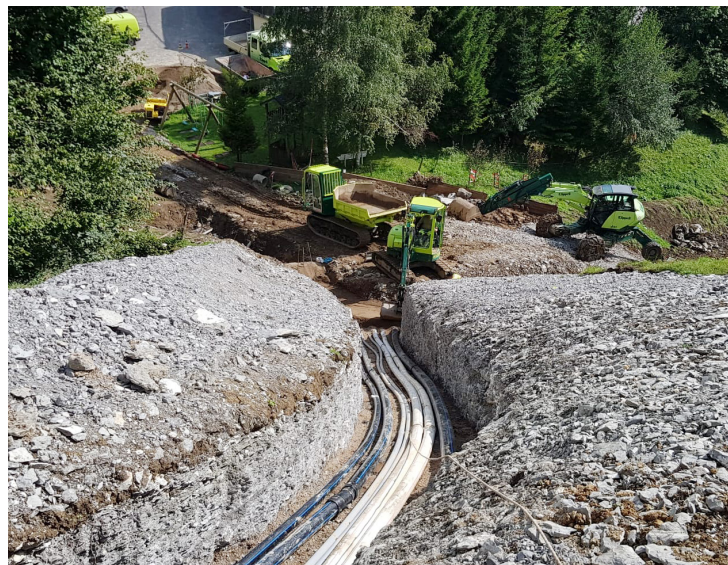
▲ Bis im Frühling 2022 sind die Bauarbeiten fertiggestellt. Hier der Blick Richtung Mütschenen.
