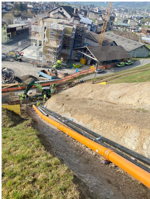
▲ Gut sichtbar die orange Abwasserleitung Richtung Laimgasse.
